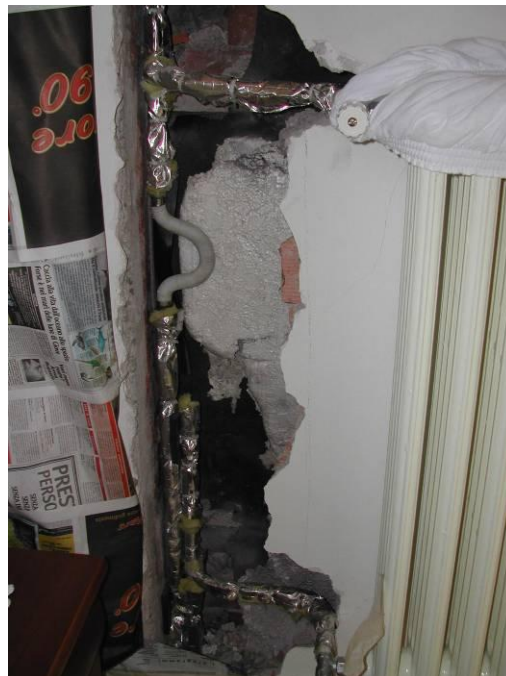
Figura 4 - In una camera da letto le tubazioni di un termosifone “smurate”. Notare il materiale isolante per le tubazioni e il giunto flessibile inserito nella mandata.
